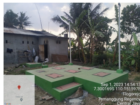
IPAL Tahu Kabupaten Temanggung
