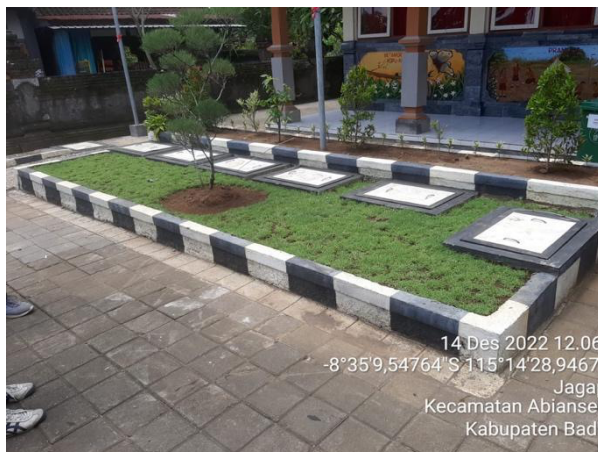
IPAL Limbah Domestik Kapasitas 150 jiwa di SDN 1 Angantaka, Jl. Wibisana No.70, Angantaka, Kec. Abiansema, Kab. Badung, Provinsi Bali
